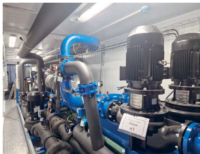
Рабочая зона контейнерной холодильной машины
