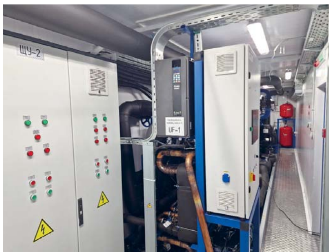
Шкафы управления контейнерной холодильной машины
