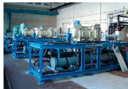
Установки на компрессорах J&E Hall на ОАО «Фармстандарт», г.Курск
