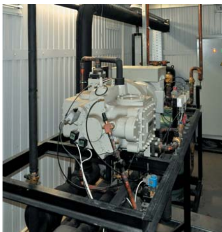
Холодильная установка для камеры шоковой заморозки креветок на компрессоре J&E Hall
