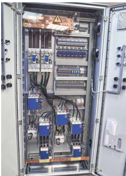
Один из шкафов управления холодильной установки
