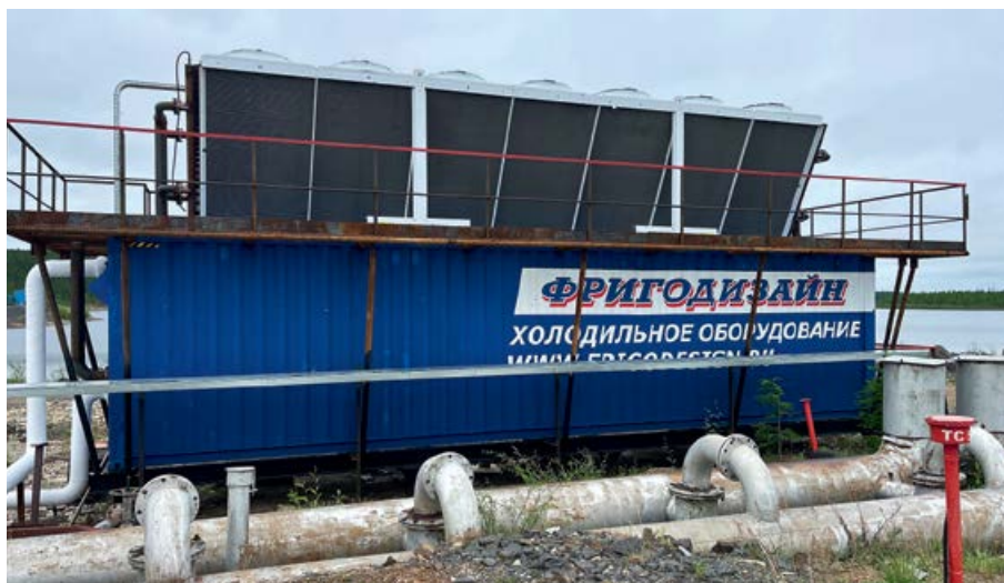
Холодильная установка после подключения к трубопроводам захлаживания дамбы
