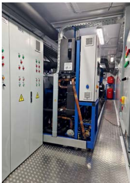
Размещение электрических шкафов управления внутри контейнера
