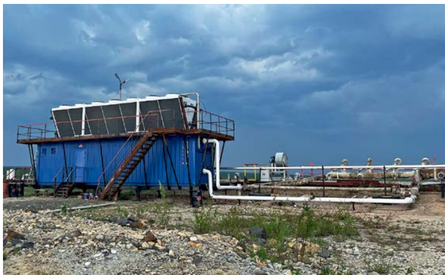
Холодильная установка сдана в эксплуатацию
