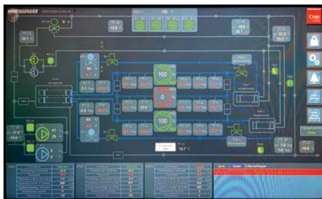
Сенсорная панель оператора холодильной установки
