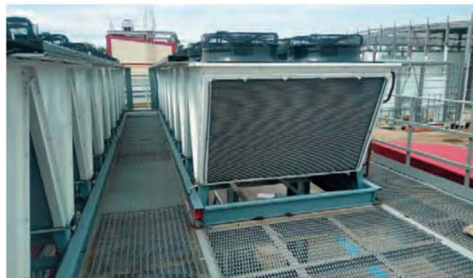
Воздушные конденсаторы с адиабатической системой увлажнения установлены на открытой площадке заказчика
