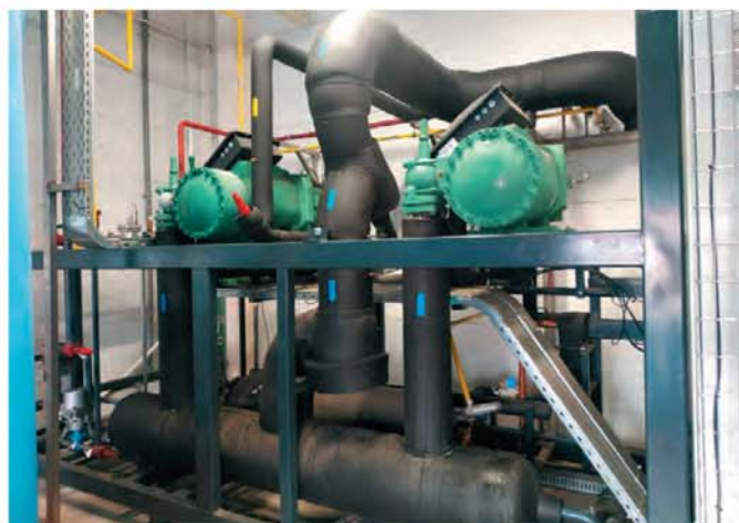
Двухкомпрессорный агрегат установки холодоснабжения фризеров после монтажа у заказчика
